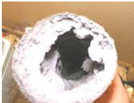
Accumulation de charpie dans un conduit de sécheuse non entretenu.
